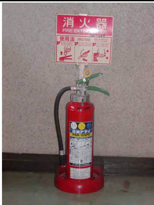
〔 消火器の設置例 〕
