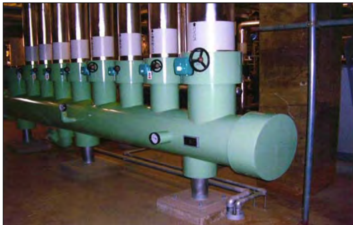
新システムに対応した管寄せ
