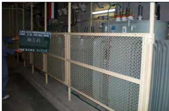
第一学群C棟電気室 改修前
