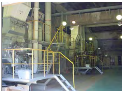
既存 多管式貫流ボイラ
