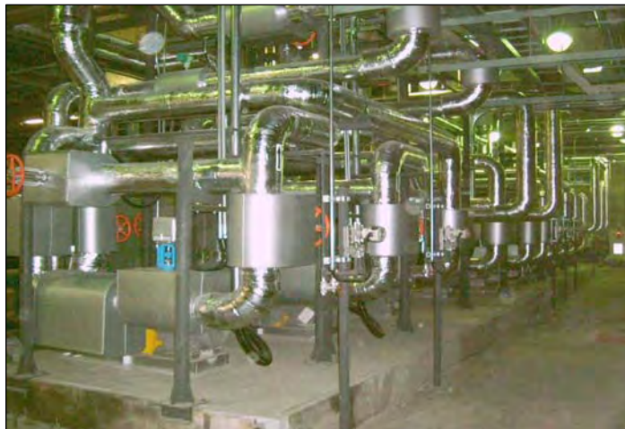
新設 高温水循環ポンプ群
