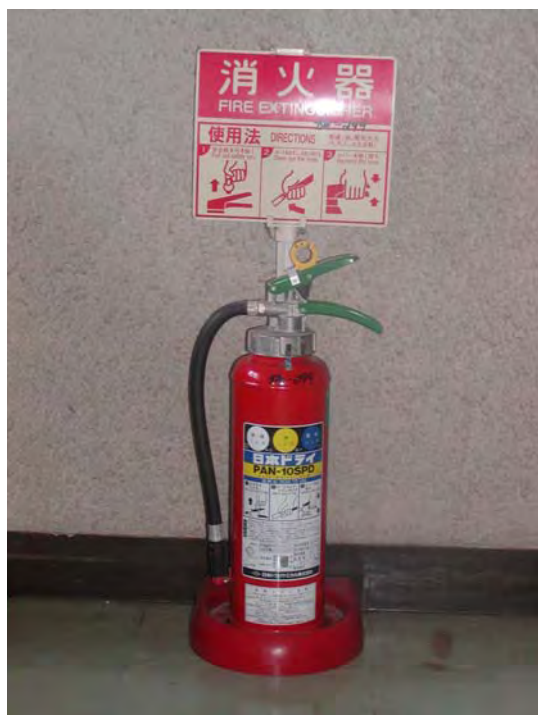
〔 消火器の設置例 〕
