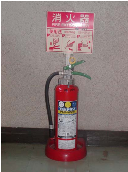
〔 消火器の設置例 〕
