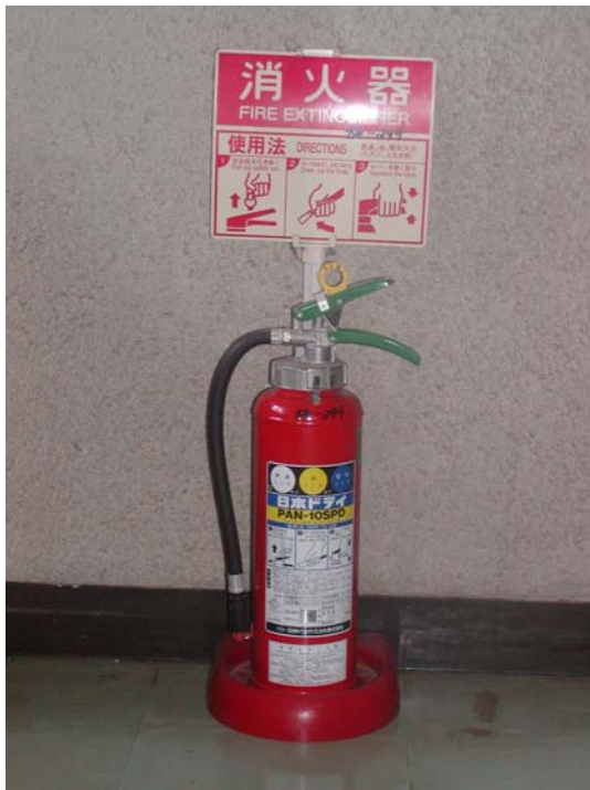
〔 消火器の設置例 〕
